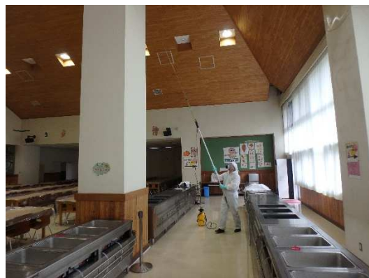
食堂内消毒作業②
